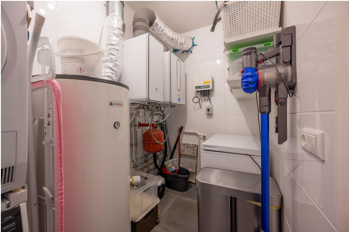
Technische ruimte en de aansluiting voor de wasmachine en droger
